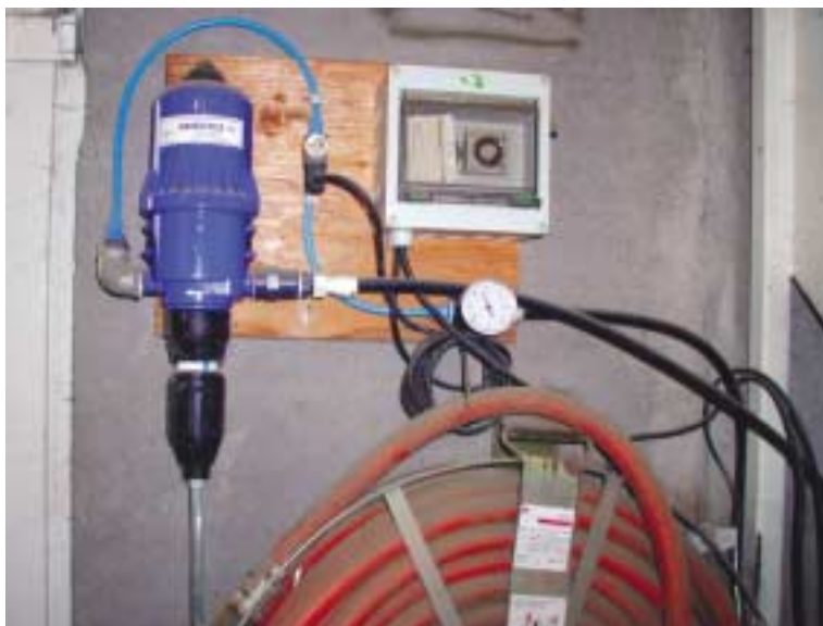
Figur 6. Forsøgsanlægget med styreenhed og doseringsanlæg til rapsolie.
